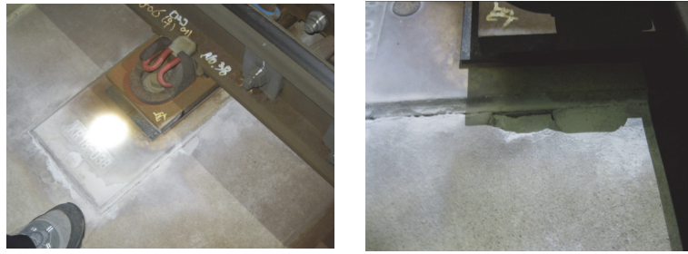
(c) 침목-도상 분리부에서의 백태, 균열, 파손
