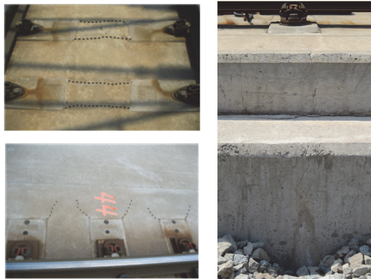
(a) 콘크리트 도상(궤도 슬래브)와 기층의 균열
