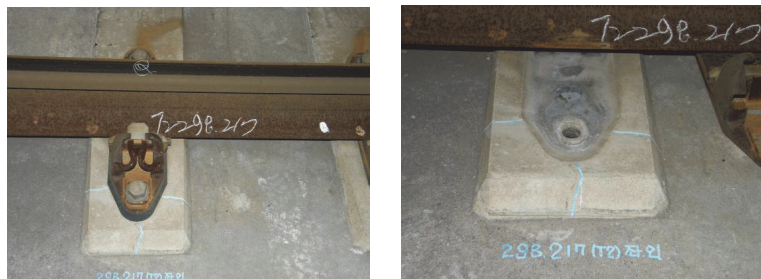
(b) PC침목 균열
